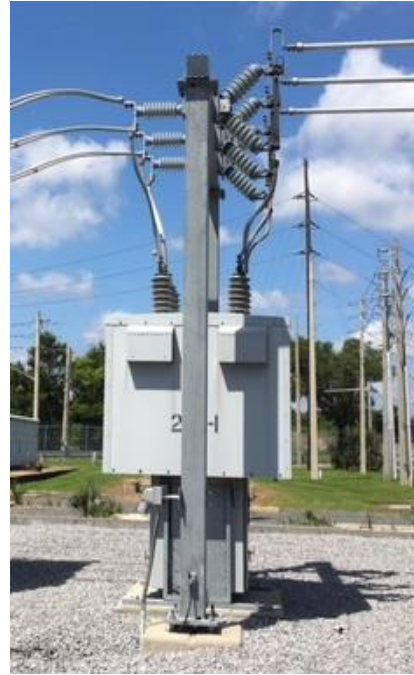
ABB TYPE V BREAKER
